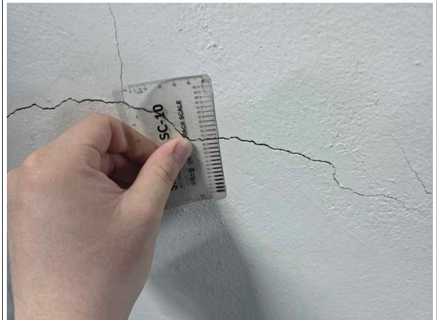
NO. 12 내력벽체 수평, 수직 균열
