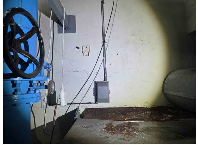
NO. 11 내력벽체 수평, 수직, 사선 균열
