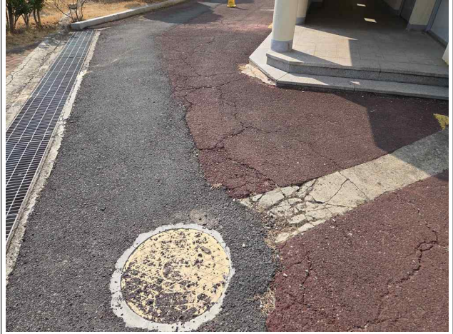
NO. 43 바닥 포장면 균열
