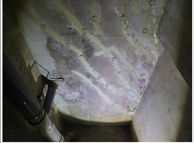
NO. 22 슬래브 보수부 누수흔적, 철근노출
