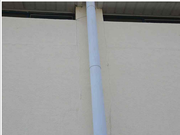
NO. 46 이질재접합부 수직 균열
