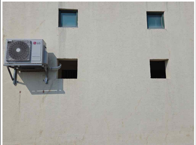
NO. 41 내력벽체 수직, 사선 균열
