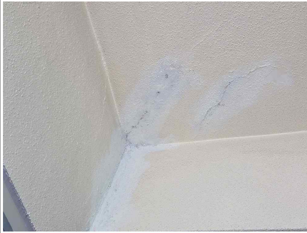
NO. 103 슬래브 균열
