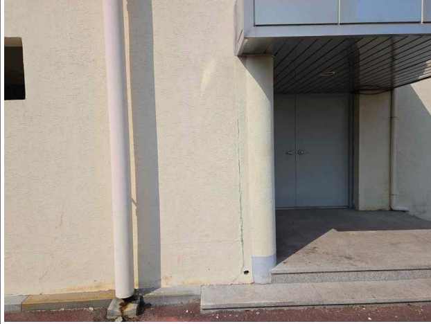
NO. 42 이질재접합부 수직 균열
