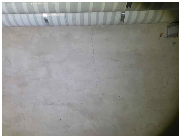
NO. 38 내력벽체 미장 균열
