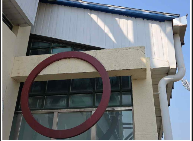
NO. 49 치장보 수직, 수평 균열
