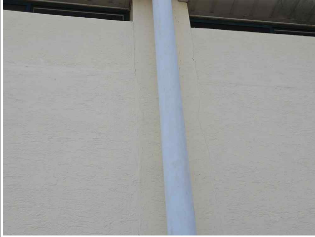
NO. 48 이질재접합부 수직 균열
