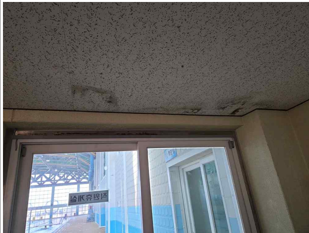
NO. 68 천정 텍스 누수흔적
