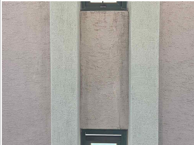
NO. 93 난간벽 수직 균열 및 백화
