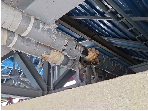
NO. 97 배관 마감재 손상
