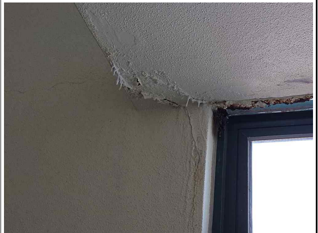
NO. 83 계단참 슬래브 균열 및 백화
