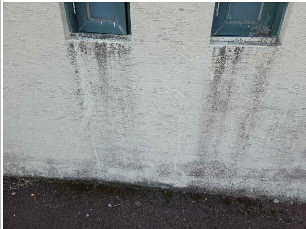
NO. 44 내력벽체 수직 균열 및 오염
