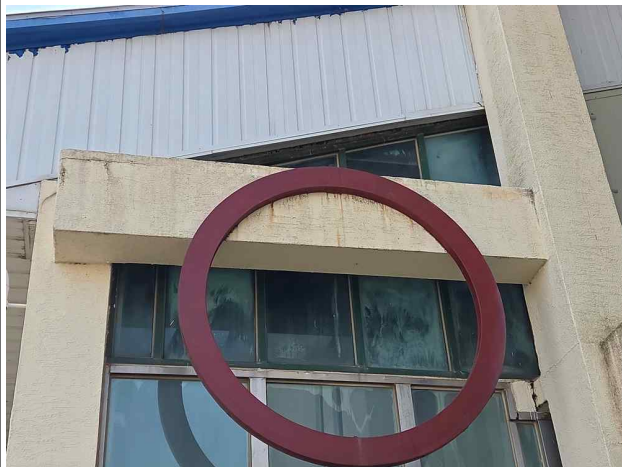
NO. 51 치장보 수평 균열
