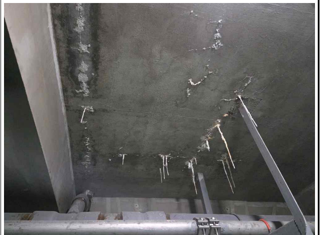
NO. 28 슬래브 균열 및 백화
