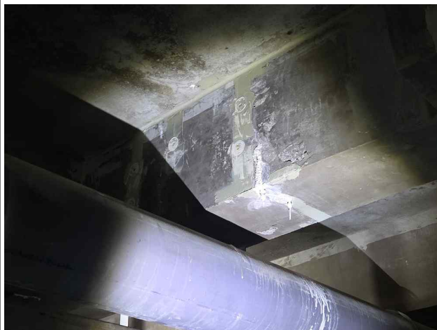
NO. 33 보 균열 및 백화
