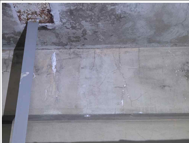
NO. 19 보 균열 및 백화
