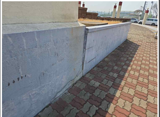
NO. 56 화단 담장 수직, 수평 균열 및 이격, 기울음
