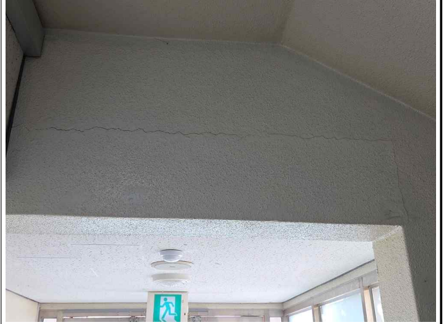
NO. 62 이질재접합부 균열
