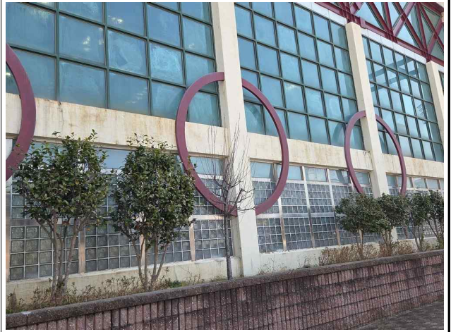
NO. 54 보 수직 균열 및 백화
