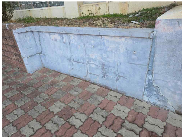
NO. 55 화단 담장 수직, 수평 균열
