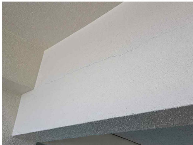
NO. 82 이질재접합부 수평 균열
