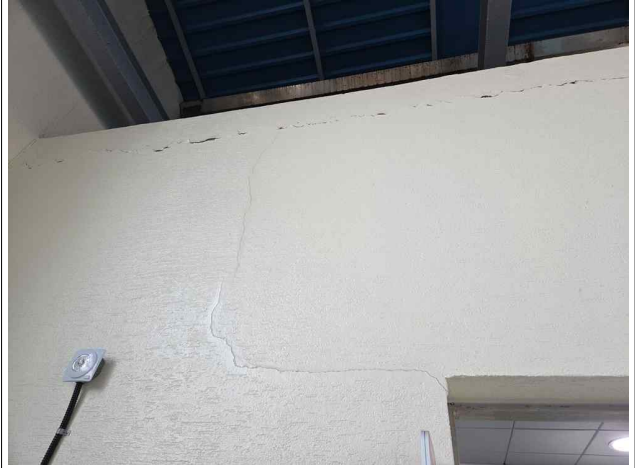
NO. 98 조적벽체 수평, 수직 균열
