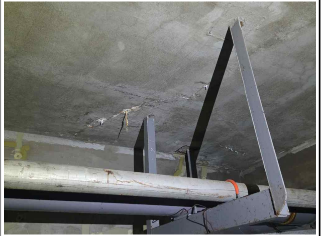
NO. 27 슬래브 균열 및 백화
