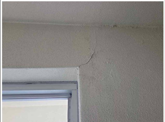
NO. 102 내력벽체 사선 균열
