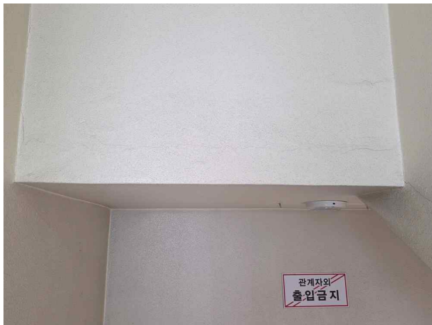
NO. 101 이질재접합부 수평 균열
