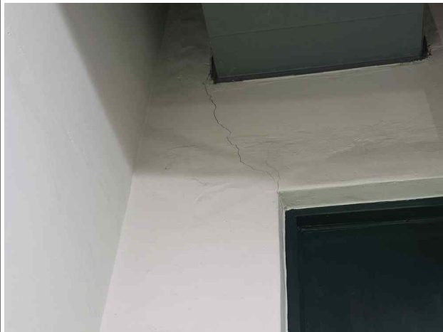
NO. 6 내력벽체 사선 관통 균열
