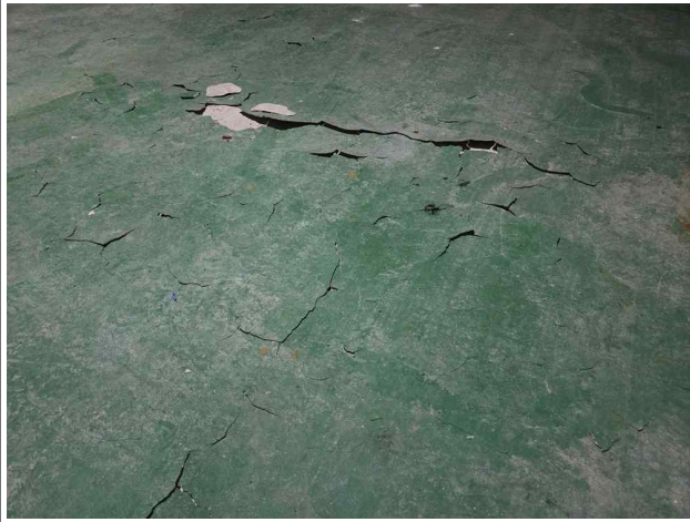
NO. 31 바닥 방수층 손상
