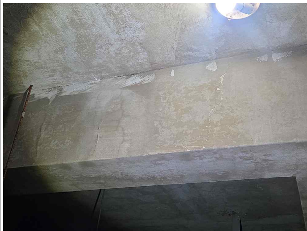
NO. 17 보 수직 균열
