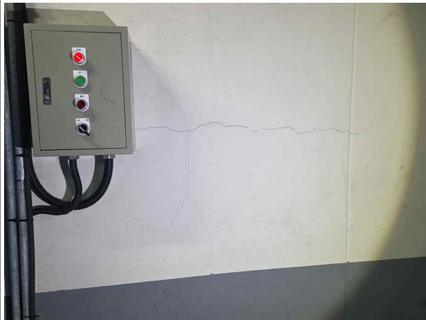
NO. 12 내력벽체 수평, 수직 균열
