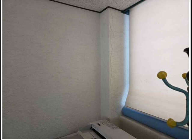
NO. 67 기동 미장 균열
