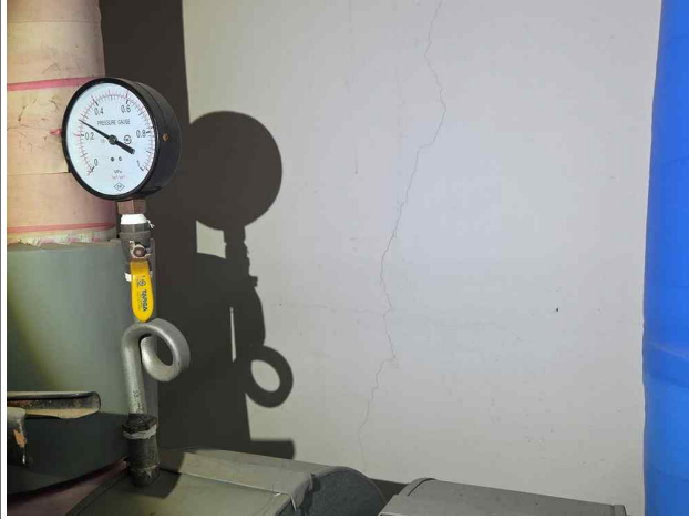
NO. 5 조적벽체 수직, 사선 균열
