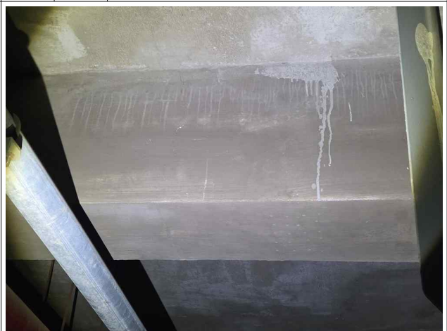
NO. 35 보 수직 균열
