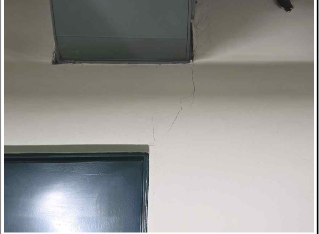
NO. 6 내력벽체 사선 관통 균열
