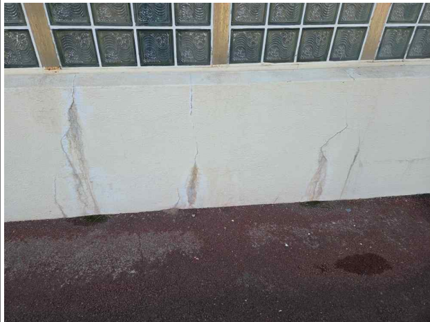
NO. 50 내력벽체 수직 균열 및 백화
