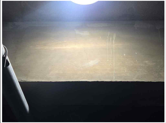
NO. 37 보 수직 균열
