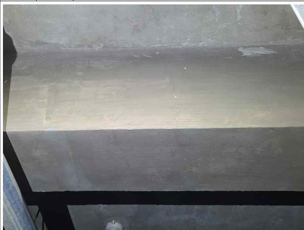
NO. 34 보 수직 균열
