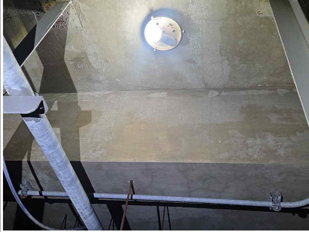
NO. 15 보 수직 균열
