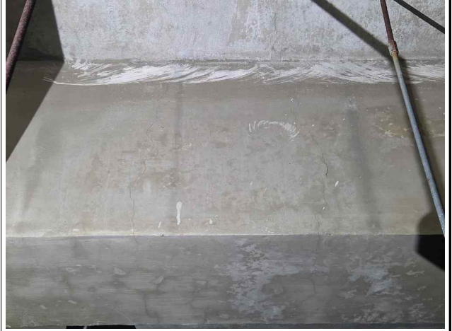
NO. 16 보 수직 균열
