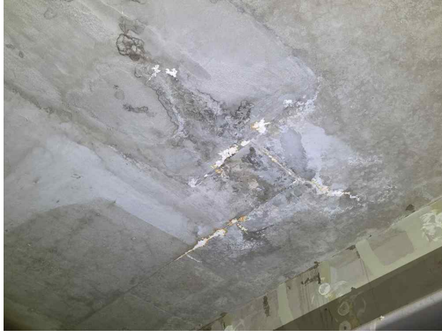
NO. 21 슬래브 균열 및 백화
