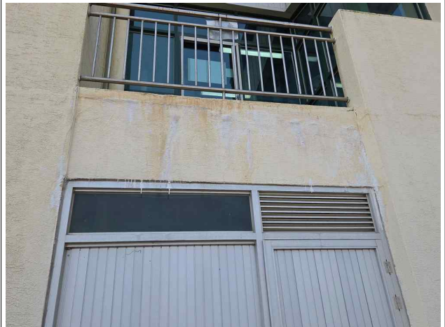
NO. 45 이질재접합부 수평 균열 및 백화
