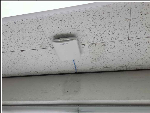
NO. 64 천정 텍스 누수흔적
