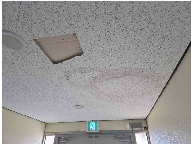
NO. 80 천정 텍스 파손 및 누수흔적
