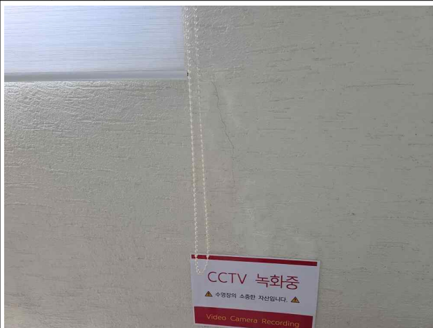
NO. 105 내력벽체 균열
