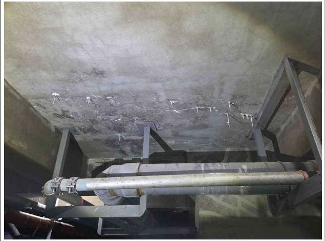
NO. 32 슬래브 백화
