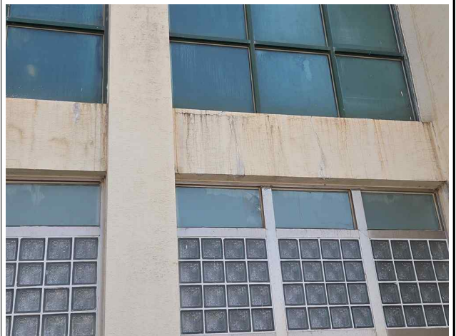
NO. 54 보 수직 균열 및 백화
