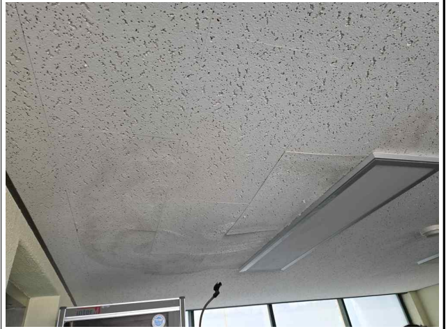
NO. 73 천정 텍스 누수흔적
