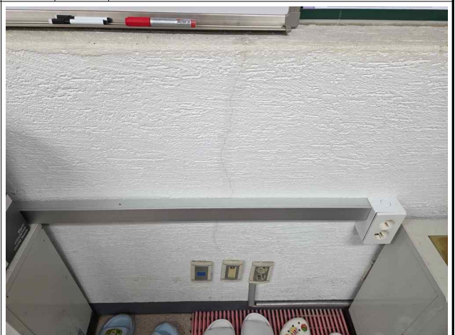
NO. 65 내력벽체 수직 균열
