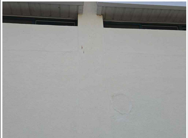
NO. 47 이질재접합부 수직 균열
