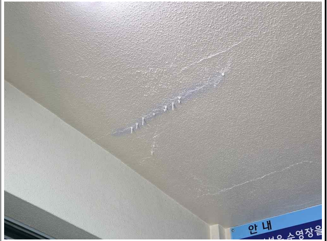
NO. 104 슬래브 균열 및 백화, 누수
