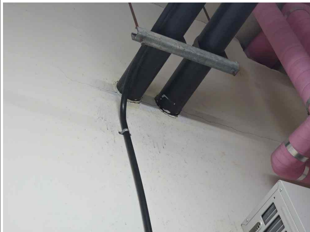
NO. 8 조적벽체 수평 균열
