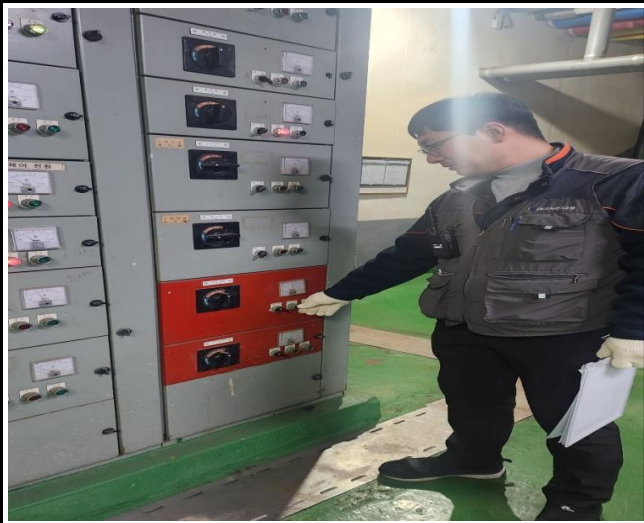
사진 설명 : 펌프실 동력제어반 점검
