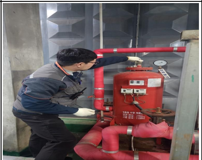
사진 설명 : 펌프실 기동용수압개폐장치 점검
