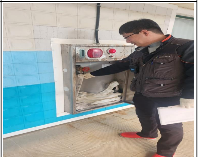
사진 설명 : 소화전 내부 점검
