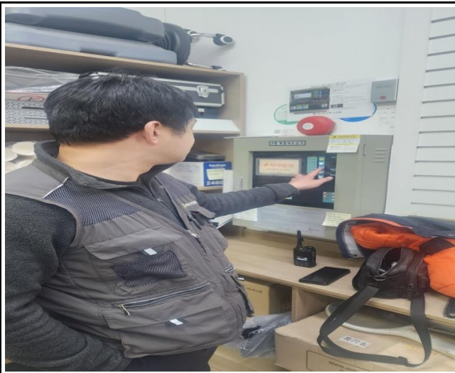
사진 설명 : 소방수신기 점검
